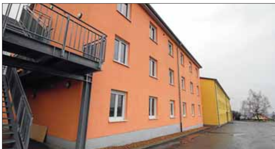
Die Bewohner der Gemeinschaftsunterkunft für Asylbewerber am Triebweg in Hardheim mussten teilweise umziehen: Grund ist ein Wasserschaden, der eine aufwändige Sanierung des Gebäudes nach sich zieht. Foto: Rüdiger Busch
