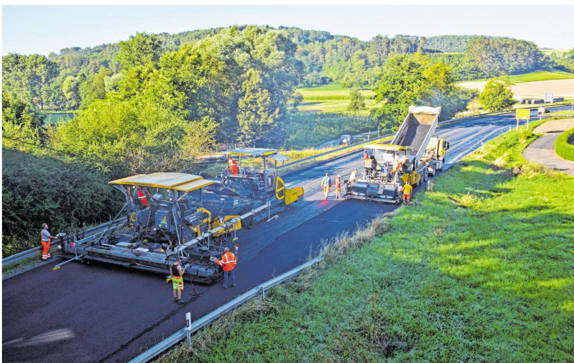
Die Arbeiten an der Erneuerung der Fahrbahndecke der Bundesstraße 27 (hier bei Königheim) gehen gut voran.
